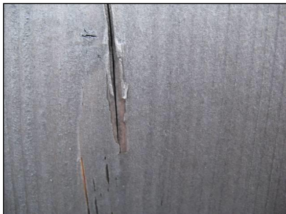
Obr. 2.2: Vznik trhlín a odlupovanie
