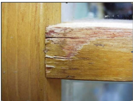
Obr. 4.5: Poškodenie v oblasti spojov
