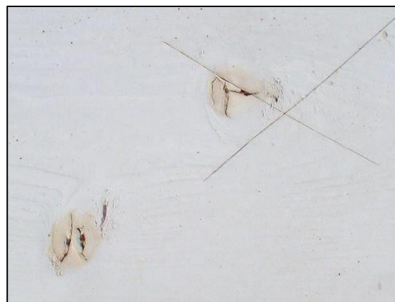
Obr. 2.7: Zafarbenie povrchovej úpravy v dôsledku rozpustných extraktívnych látok v oblasti hrčí
