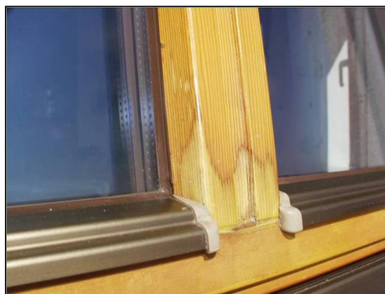
Obr. 4.6: Poškodenie v oblasti spojov
